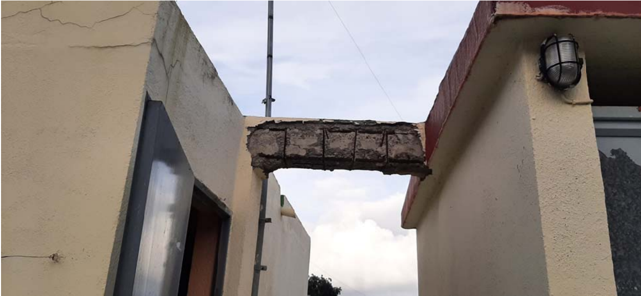
Fotografía nº2: Bloque 10. Patologías estructurales.
