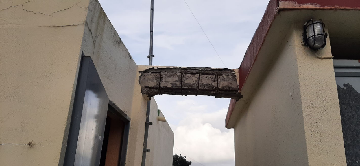
Fotografía nº2: Bloque 10. Patologías estructurales.
